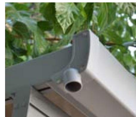
Vestavěné okapy a systém na odvod vody
