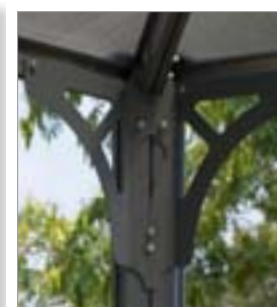
Pevná bezúdržbová konstrukce
