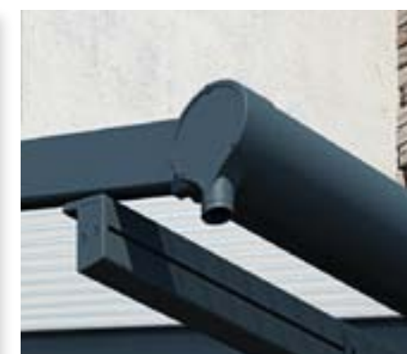
Integrovaný systém na odvod vody
